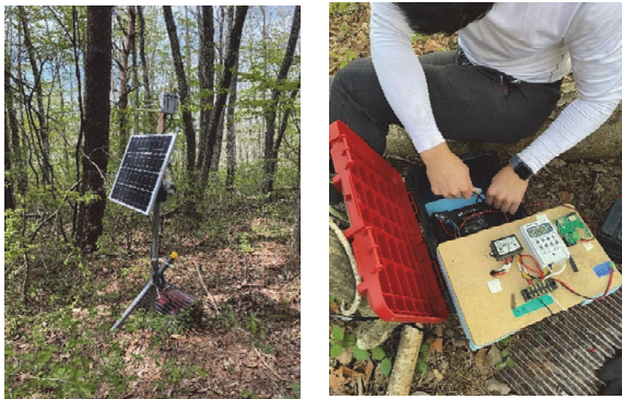
図2 山林に設置された LoRa 中継器と電池交換作業の様子
