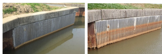
図-2 左：試験施工時、右：試験施工から5年
