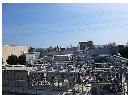
図2 中央浄化センターの消化ガス発電設備
