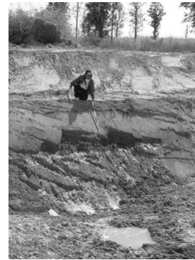
Fig.1 ため池掘削面に露出した地下水脈
