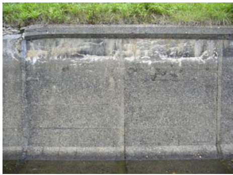
写真-1 RC開水路内面の凍害発生位置 (北側側壁・山側の水路内面)
