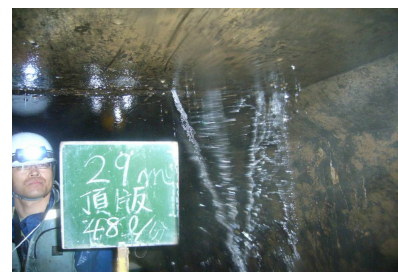
図 - 5 空水状態で目視調査した目地からの漏水状況(漏水量・大)
