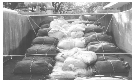
図 2 試験設置された魚道
