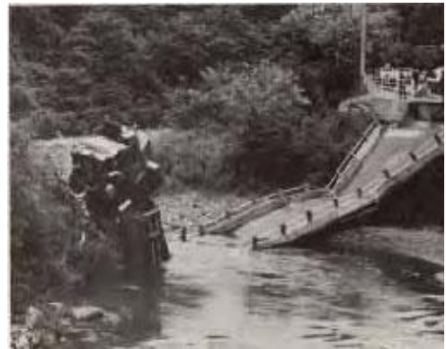
写真-1 新菅（PC橋）の落橋
