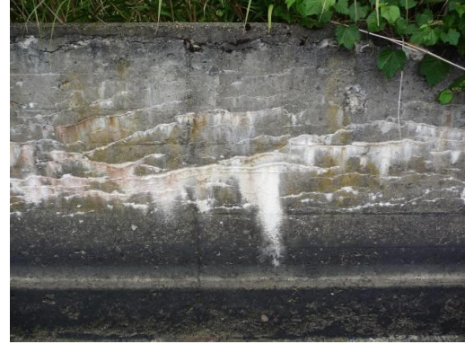
図1 凍害損傷が顕在化した計測対象断面
