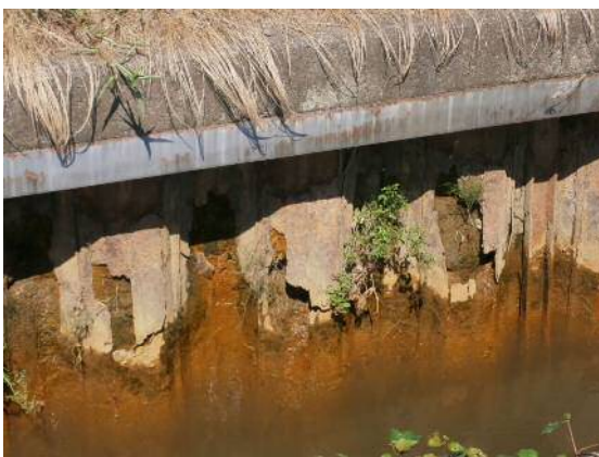
(1) 断面欠損が極度に進行した鋼矢板
