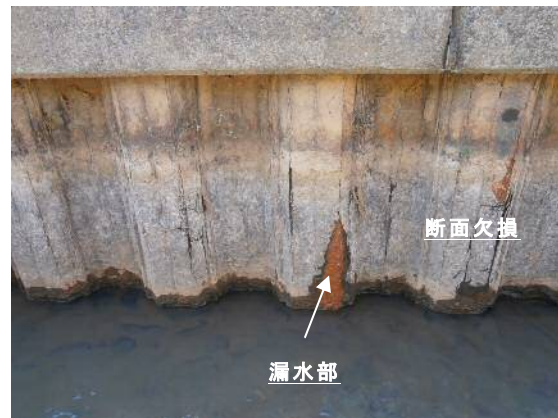
(2) 漏水および断面欠損
