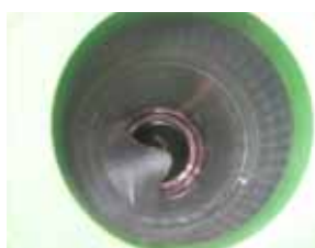
図5 更生管座屈状況
