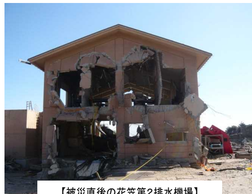
【被災直後の花笠第2排水機場】
