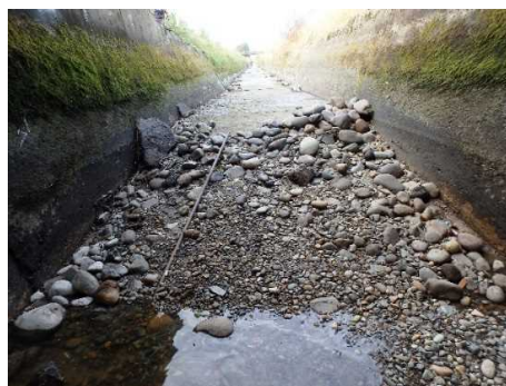
Fig.1 大量の石礫が堆積した落差工
