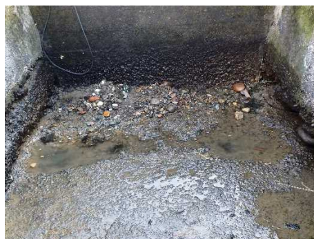
Fig.2 激しく摩耗した落差工底版
