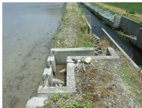
写真1 水田魚道の設置状況 (2016年5月29日撮影)
