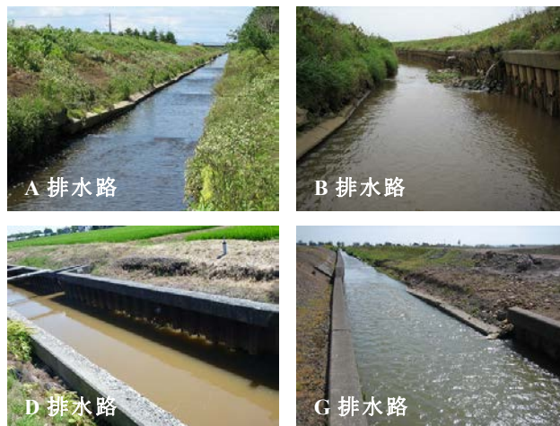
Fig.1 排水路鋼矢板の腐食
