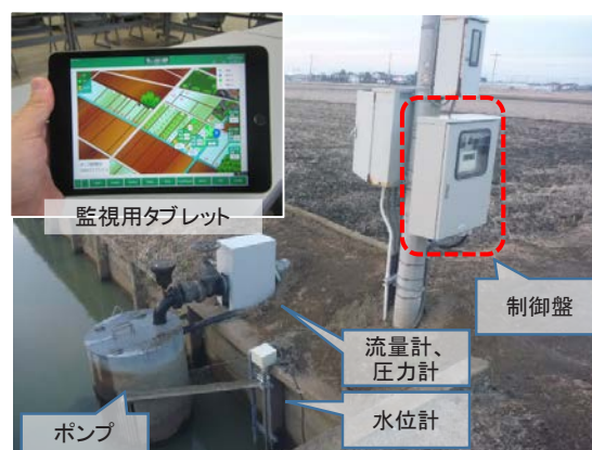
写真 1 ポンプ灌漑地区に設置したシステム The installed system in a pump irrigation area
