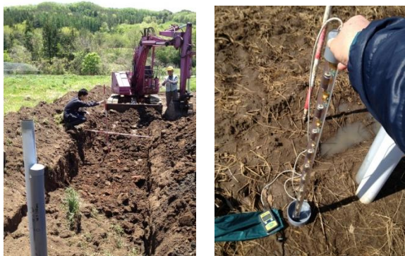
Fig.1 汚染表土の埋設工事の様子（左）と土壌放射線測定器「長尺くん」（右）
