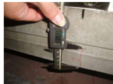
図2 ひび割れ状況例
