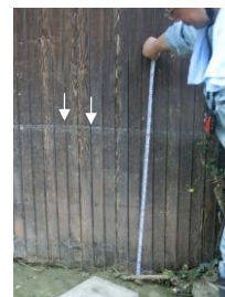
Fig. 4 家屋の浸水痕跡 (Fig. 2 中⑪; 7月25日撮影)
