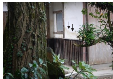
Fig. 3 家屋の浸水痕跡 (Fig. 2 中⑦; 9月15日撮影)
