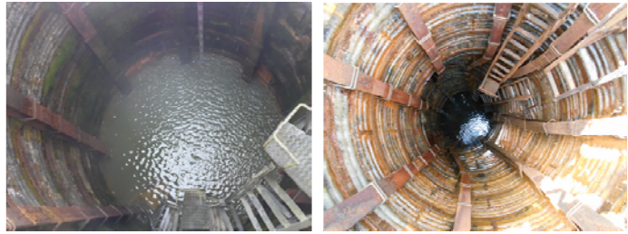
図3 異常湛水(左)、井筒本体の変形(右)
