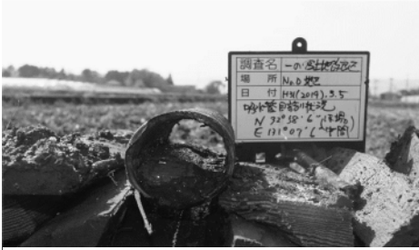
写真-1 吸水管の土砂堆積状況
