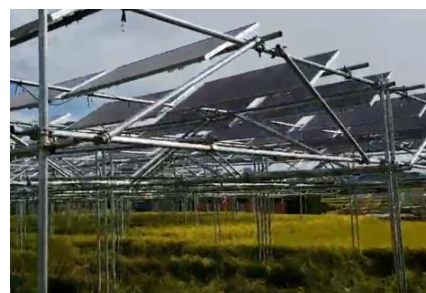
写真1 施工田の様子 (丸亀市) An agro-photovoltaic fields in Marugame city
