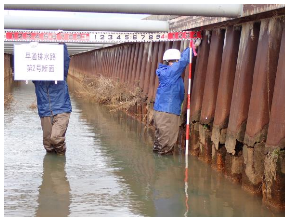
写真-1 早通排水路・座屈破壊状況
