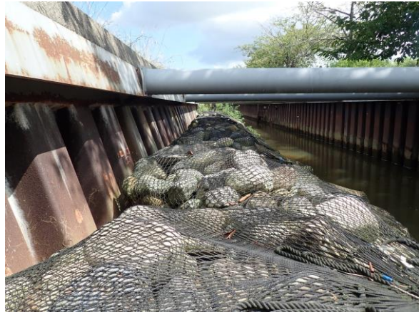
写真-2 清五郎排水路（左岸側）・座屈破壊状況
