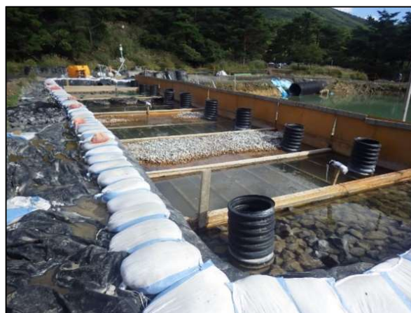
石灰石による中和処理実証実験施設
