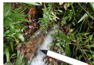
写真-4 漏水量増加 (2020. 7. 15)
