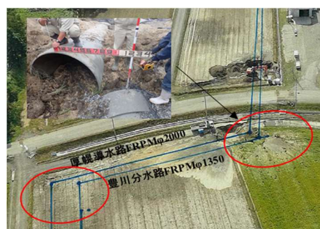
Fig. 1 厚幌導水路の離脱破壊 2)
