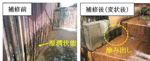
図3 滲み出し変状事例
