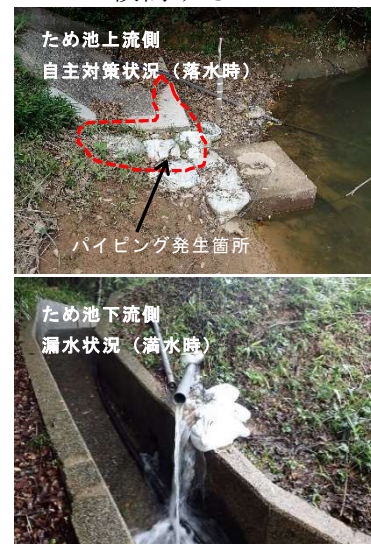
図1 パイピング状況(洪水吐左岸側)
